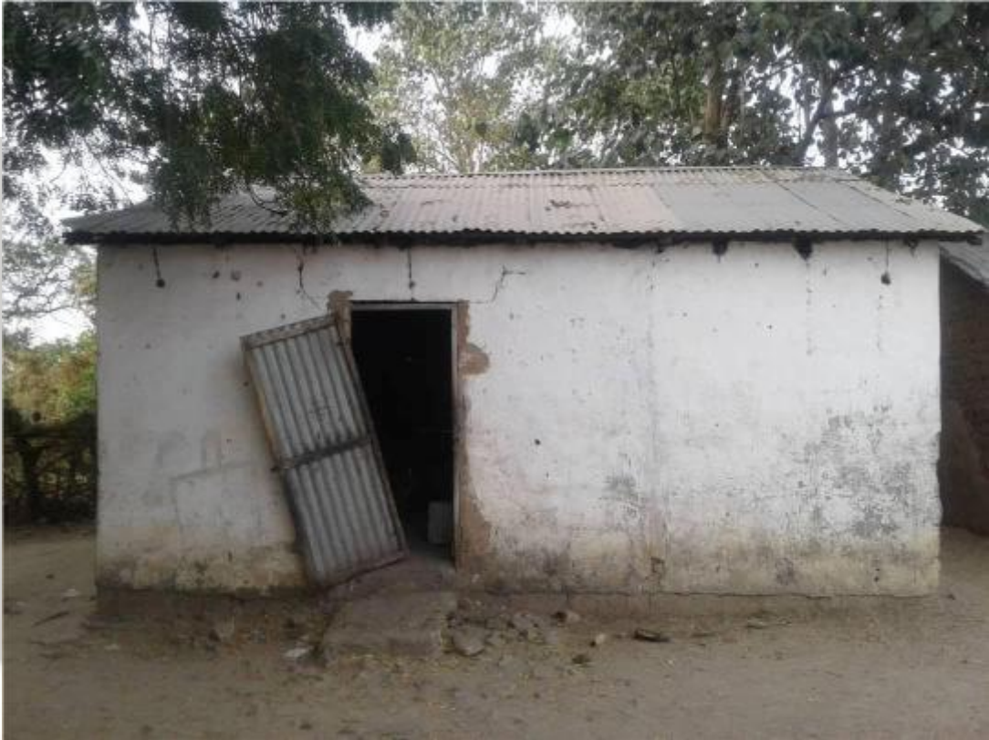
Foto: Alter Zustand der Schulküche, das Gebäude war einsturzgefährdet und innen von Schimmel befallen
